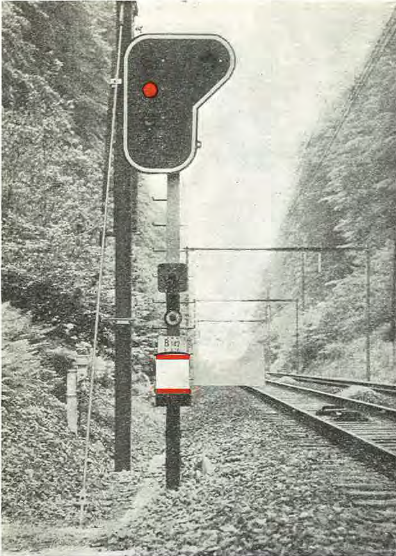
Signal automatique permanent fermé.
